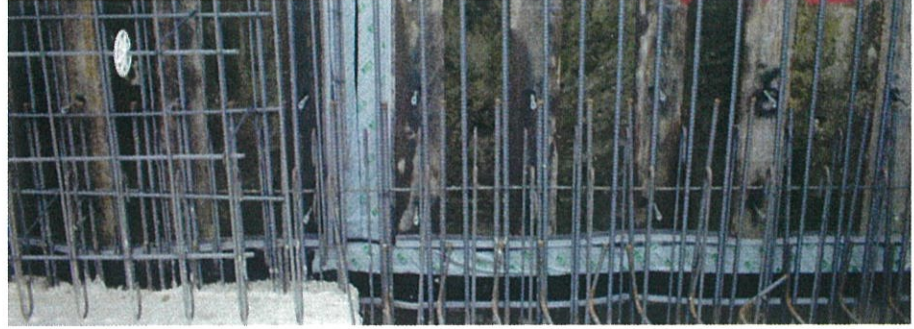
RGS交差部取付状況
