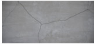
初期ひび割れ
