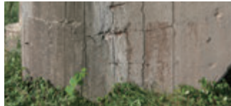
劣化した橋脚
