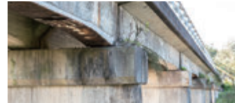
劣化した橋梁
