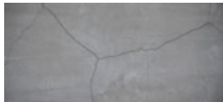
初期ひび割れ
