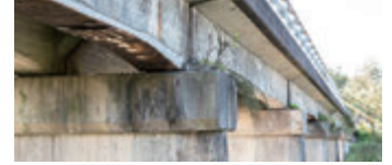
劣化した橋梁
