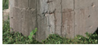
劣化した橋脚
